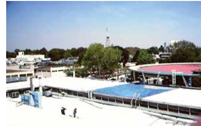
seal coating 118 sp aplicado en Laboratorios Merck Sharp & Dohme de Mexico S.A. de C.V. Zona Mezaninne. 1,875.00 M2. 2000.
