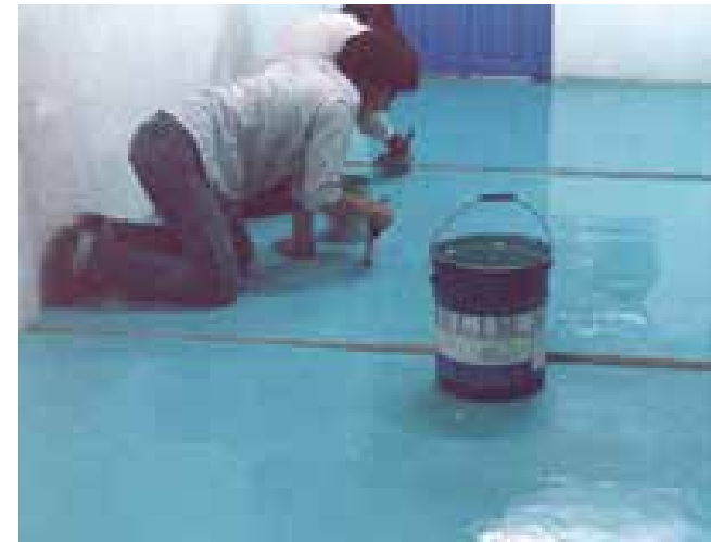
epoxy floor coating aplicado en 5° nivel, ductos 1, en el Hotel Sheraton Ma. Isabel. 1,500.00 M2. Ciudad de México. 1990.
