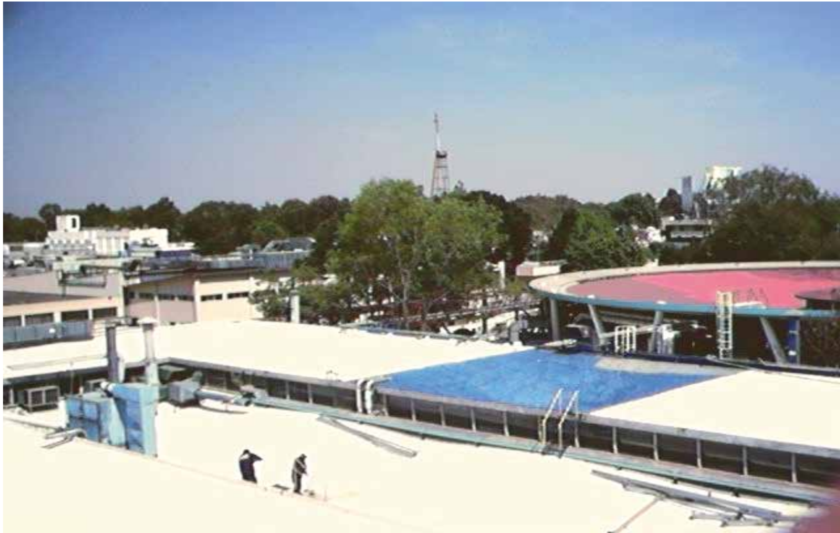
Vista general de los trabajos de impermeabilización con el Sistema imper slim 80 en Laboratorios Merck Sharp & Dohme. Ciudad de México.
